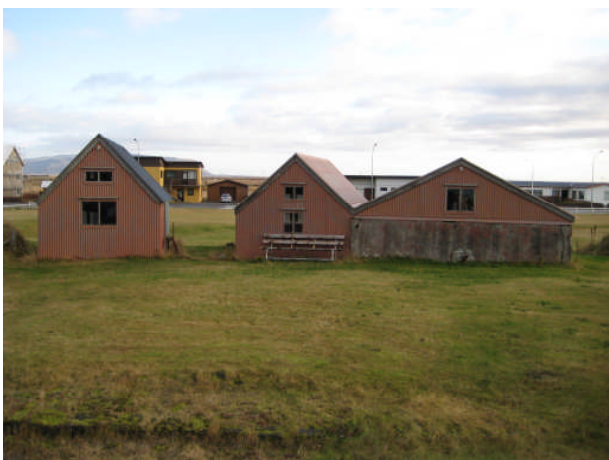
Útihúsin norðaustan við Húsið bíða viðgerða.
